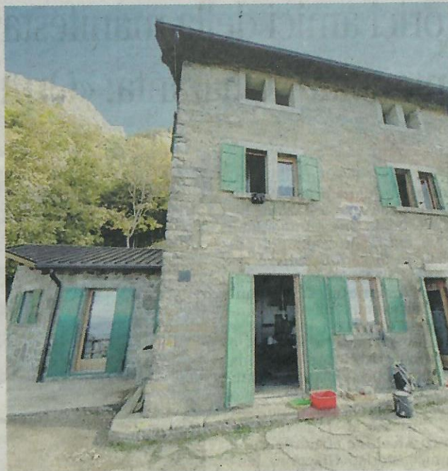
Il Rifugio Elisa dopo i lavori di ampliamento è pronto a riaprire
