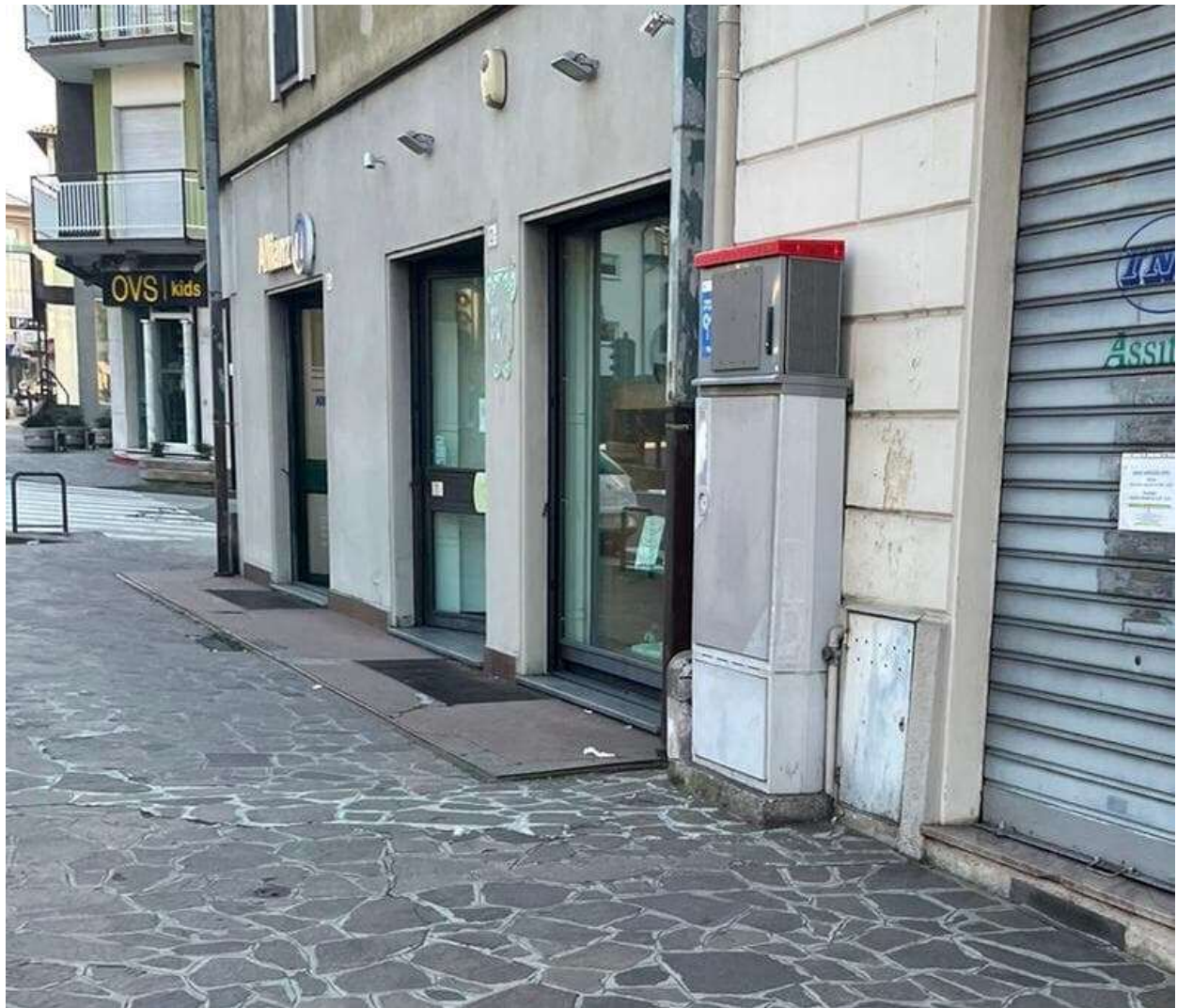
La centralina presa di mira dai topi.-2
