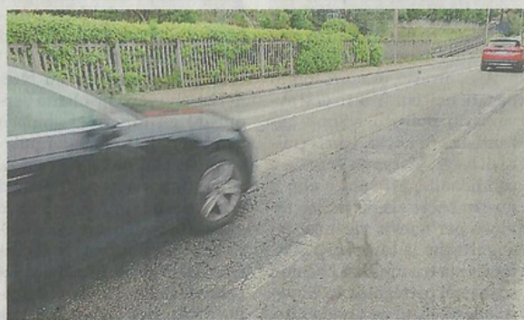
L'asfalto attuale presenta screpolature e affossamenti
